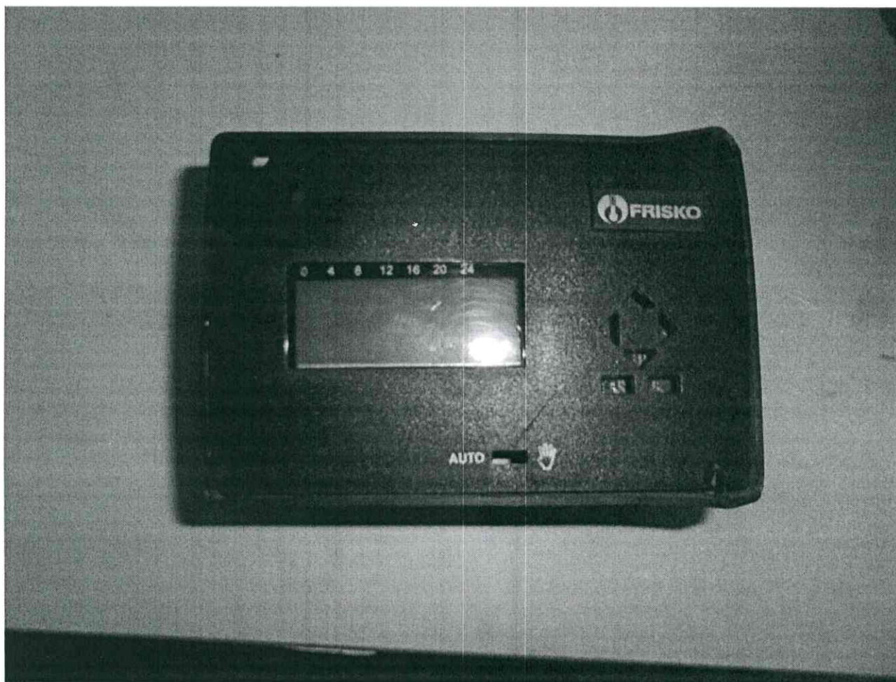
Sterownik RX 910 MULTICO 2003 rok Oczyszczalnia ścieków Mleczno Nr ew:02 211 / 686
