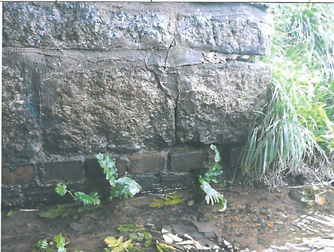
Fot. 13. Przyczółek prawobrzeżny od strony górnej wody widoczne ubytki i rozluźnienie spoin, zacieki, w dolnej części ubytki cegieł korpusu.
