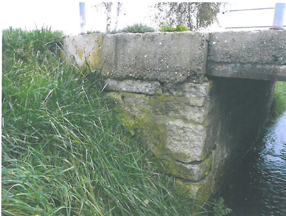
Fot. 15. Skrzydło lewobrzeżne od strony dolnej wody, korozja betonu elementu, ubytki spoin w części kamiennej.
