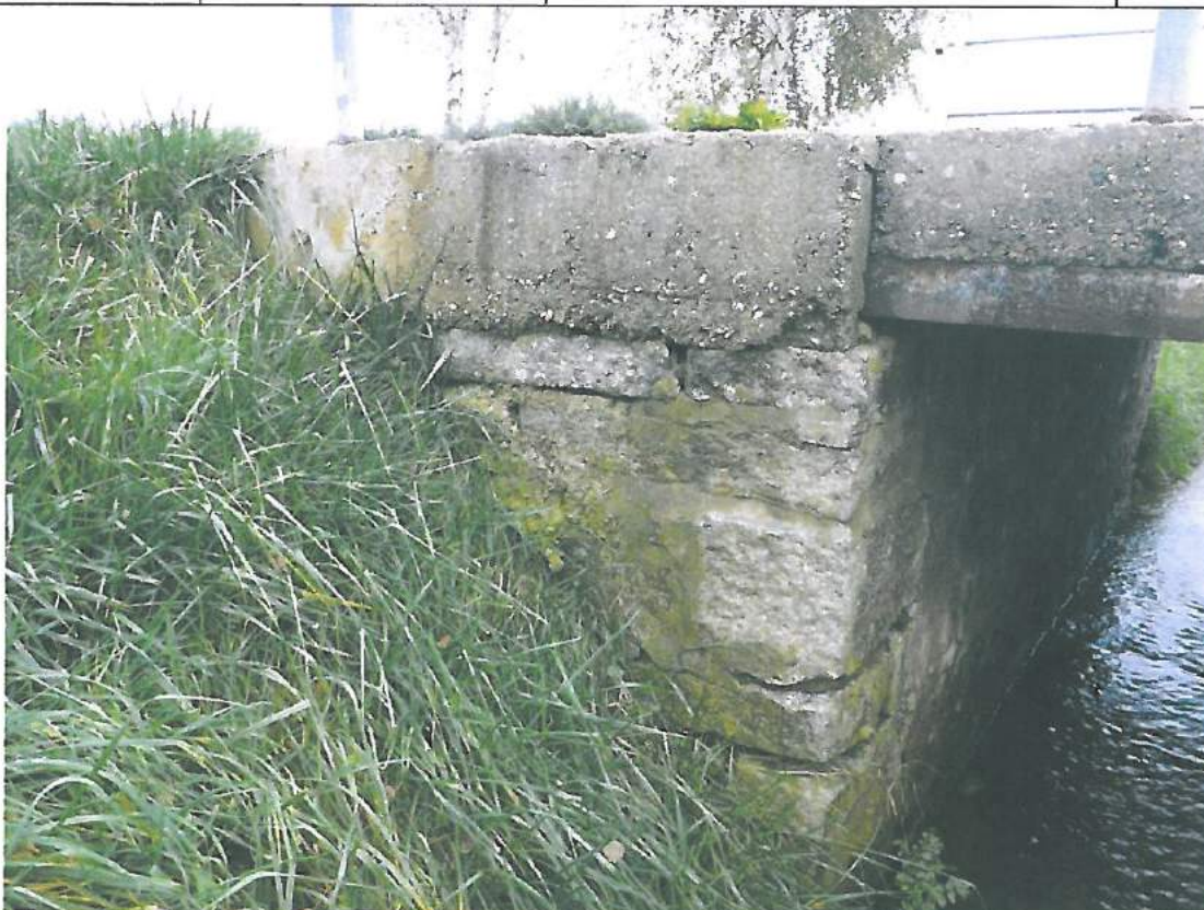
Fot. 15. Skrzydło lewobrzeżne od strony dolnej wody, korozja betonu elementu, ubytki spoin w części kamiennej.
