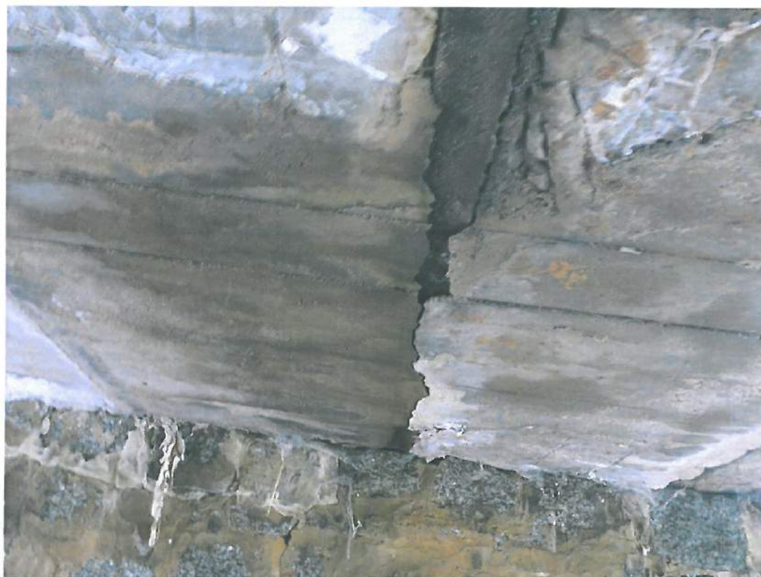
Fot. 10. Przecieki oraz odspojenia betonu i korozja stalowego kształtownika.
