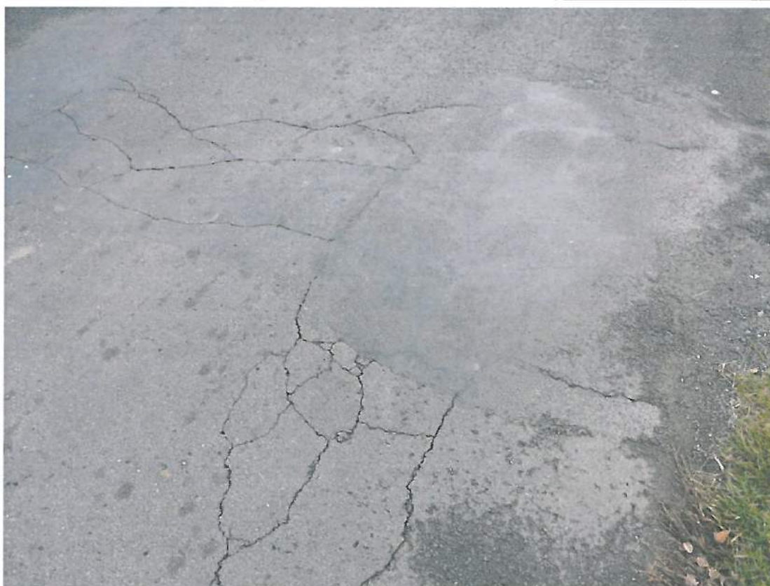
Fot. 2. Widoczne spękania oraz deformacja nawierzchni na dojeździe od strony lewego brzegu.
