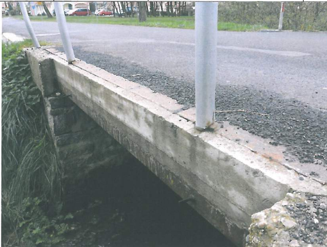
Fot. 17. Belka gzymsowa od strony dolnej wody. Widoczne mocowanie balustrady do istniejących stalowych elementów belki gzymsowej.
