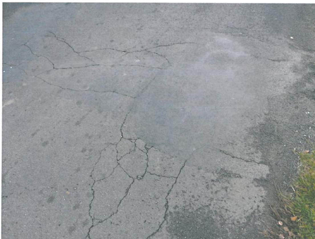
Fot. 2. Widoczne spękania oraz deformacja nawierzchni na dojeździe od strony lewego brzegu.
