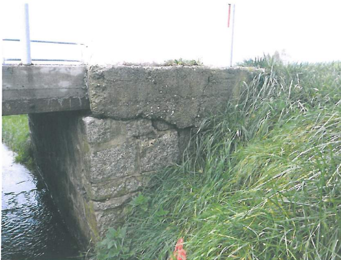
Fot. 16. Skrzydło prawobrzeżne od strony górnej wody, korozja i spękania betonu elementu, ubytki spoin w części kamiennej, porastająca roślinność na skarpie.
