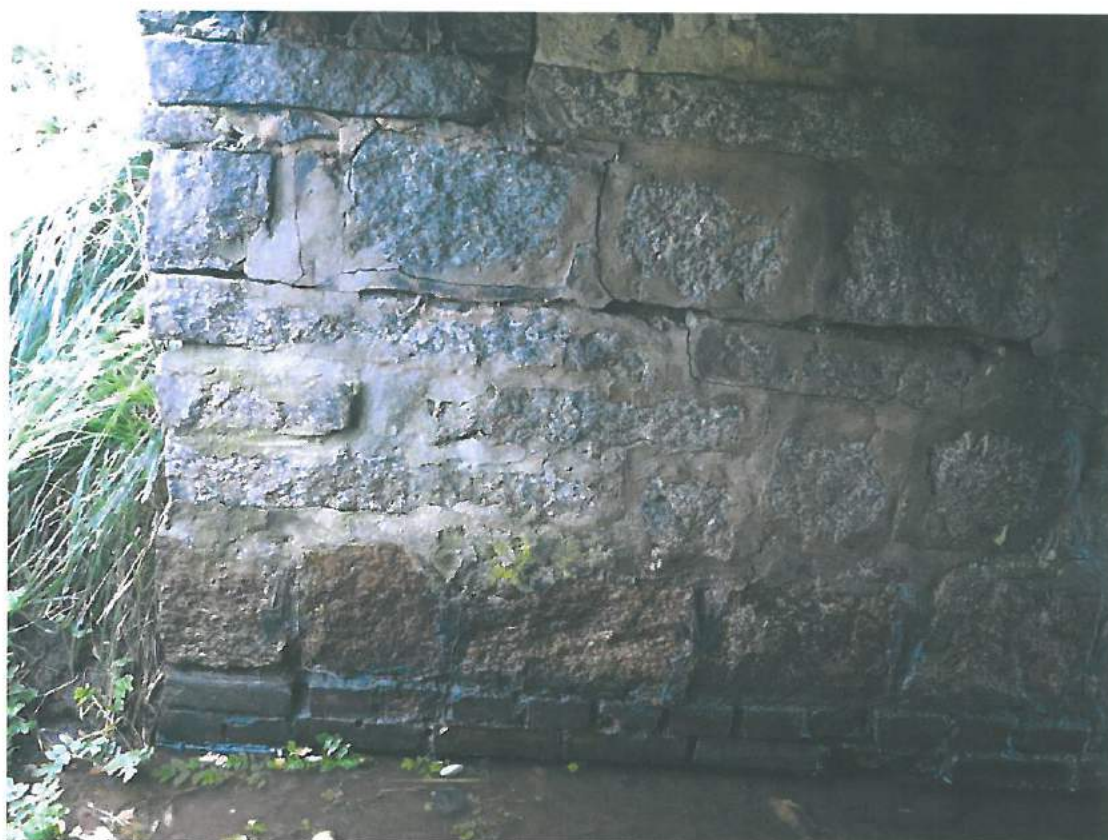
Fot. 12. Przyczółek prawobrzeżny od strony dolnej wody widoczne ubytki i rozluźnienie spoin, zacieki, w dolnej części ceglana część korpusu.
