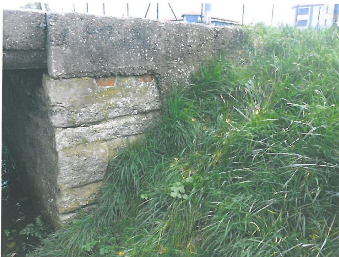
Fot. 14. Skrzydło prawobrzeżne od strony dolnej wody, korozja betonu elementu.
