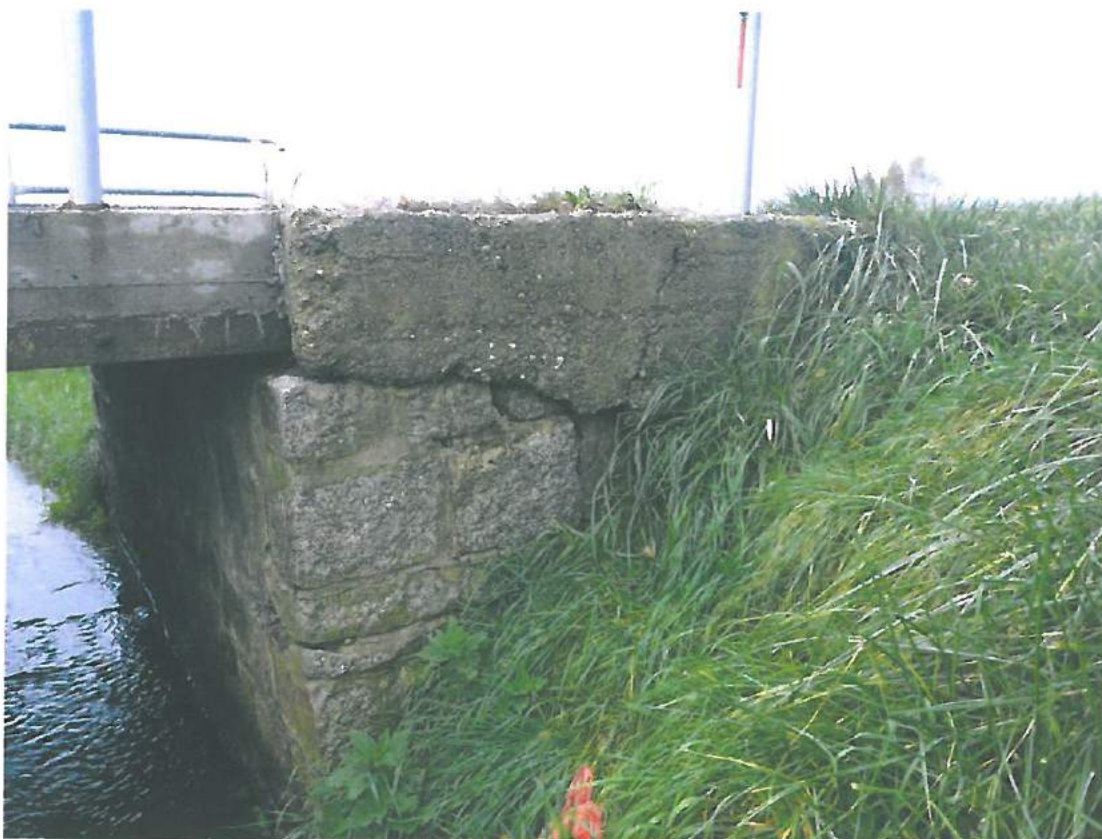
Fot. 17. Skrzydło prawobrzeżne od strony górnej wody, korozja i spękania betonu elementu, ubytki spoin w części kamiennej, porastająca roślinność na skarpie.
