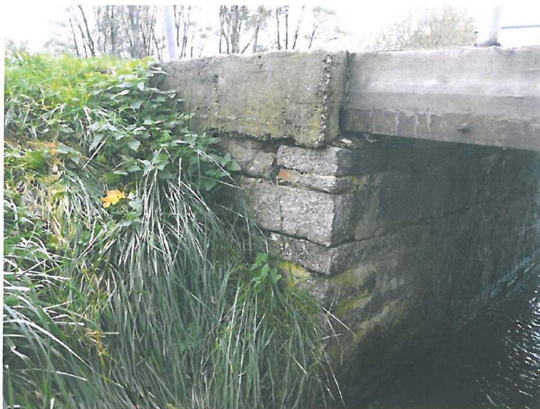
Fot. 16. Skrzydło lewobrzeżne od strony górnej wody, korozja betonu elementu, ubytki spoin w części kamiennej, porastająca roślinność na skarpie.
