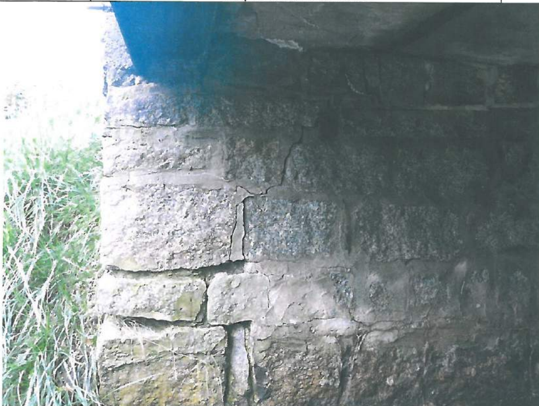
Fot. 11. Przyczółek lewobrzeżny od strony górnej wody, widoczne ubytki spoin oraz zawilgocenia kamiennego korpusu przyczółka.
