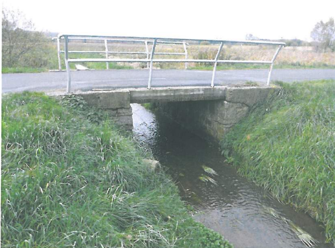
Fot. 5. Widok konstrukcji z boku od strony dolnej wody. Widoczne kamienne przyczółki oraz nadbudowane skrzydełka z betonu.
