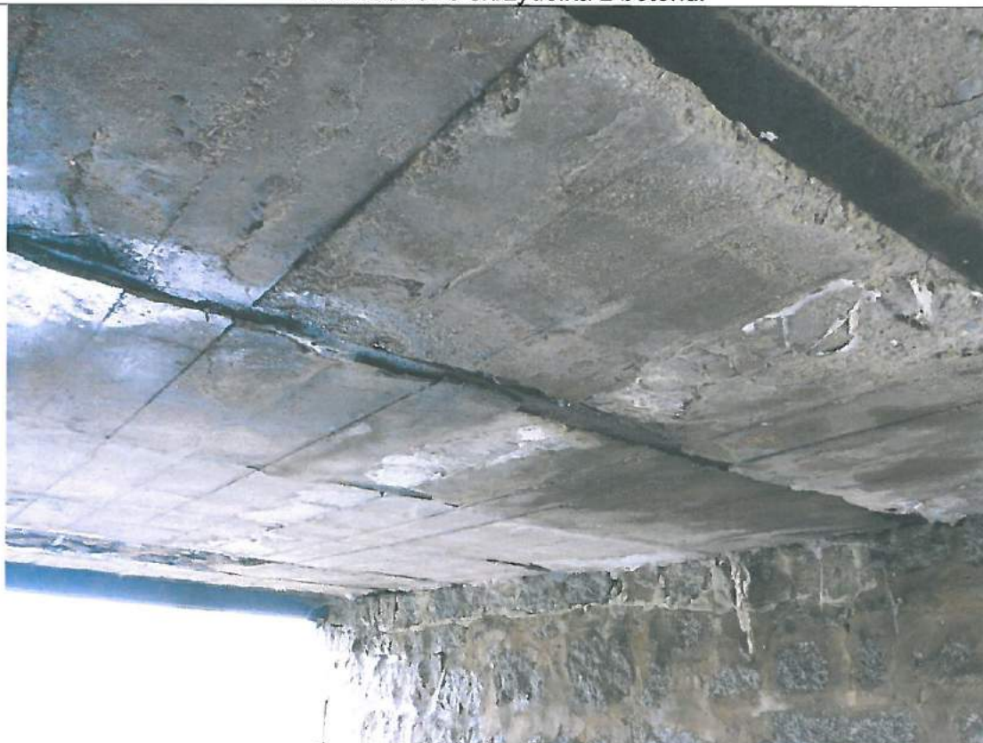
Fot.6. Widok spodu konstrukcji. Rozległe przecieki, białe wykwity, korozja betonu oraz dźwigarów stalowych.
