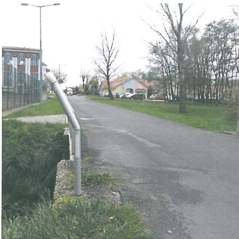
Fot. 18. Balustrada stalowa na obiekcie nie stanowi normatywnego zabezpieczenia przed wypadnięciem pojazdów poza obiekt brak wydzielonego ciągu pieszego na obiekcie w pobliżu szkoły.
