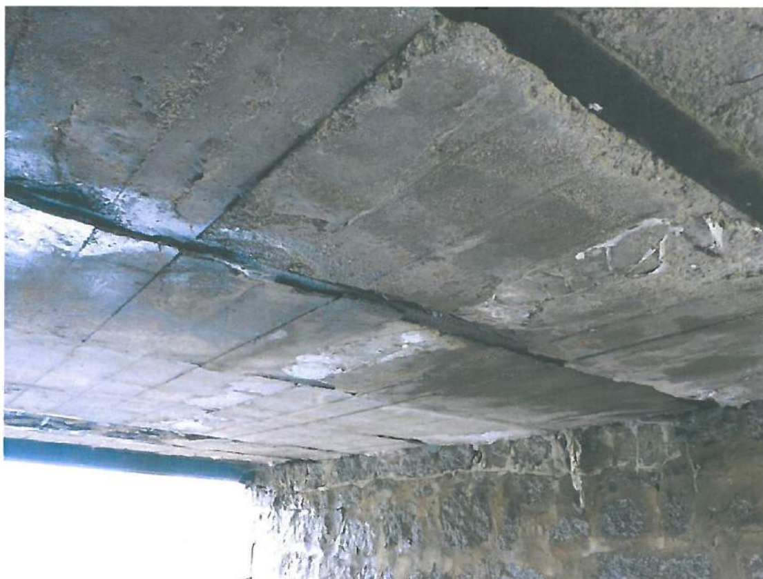
Fot. 6. Widok spodu konstrukcji. Rozległe przecieki, białe wykwity, korozja betonu oraz dźwigarów stalowych.
