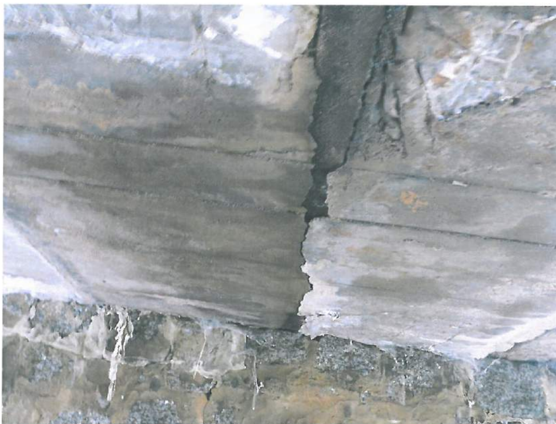
Fot. 10. Przecieki oraz odspojenia betonu i korozja stalowego kształtownika.
