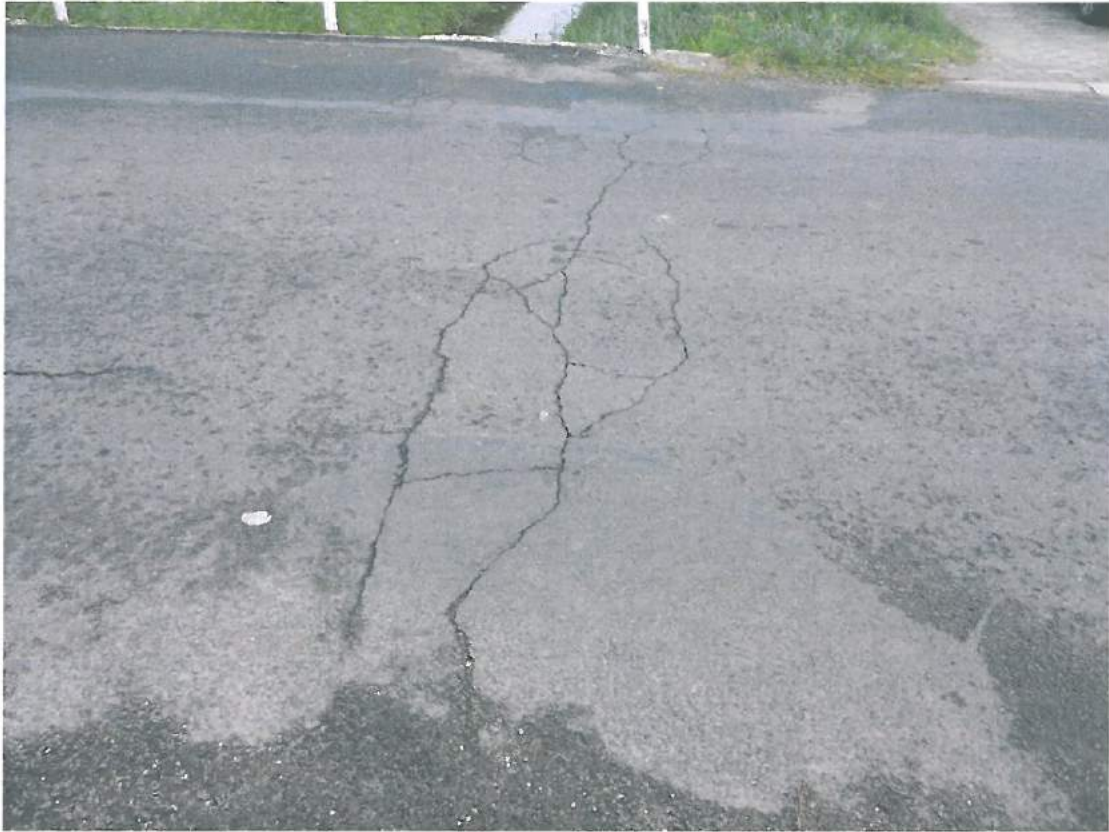
Fot. 3 – Widoczne spękania oraz deformacja nawierzchni na dojeździe od strony prawego brzegu.
