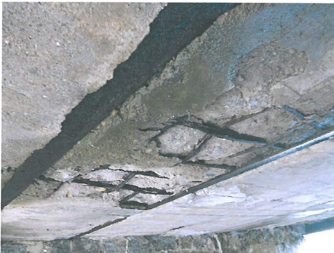
Fot. 8. Widoczny spód konstrukcji, korozja odspojenia i ubytki betonu, zaawansowana korozja zbrojenia.
