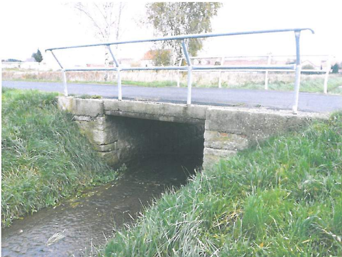
Fot. 4 – Widok konstrukcji z boku od strony górnej wody. Widoczne kamienne przyczółki, ubytki spoin.
