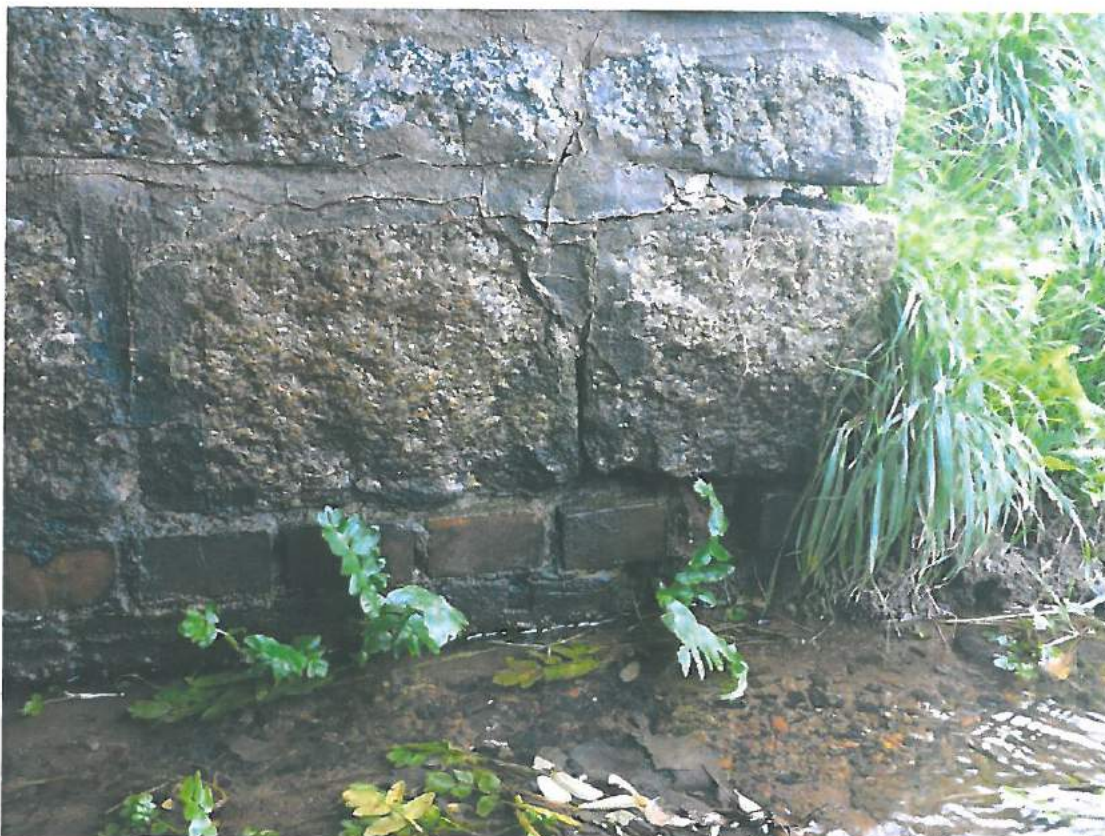
Fot. 13. Przyczółek prawobrzeżny od strony górnej wody widoczne ubytki i rozluźnienie spoin, zacieki, w dolnej części ubytki cegieł korpusu.
