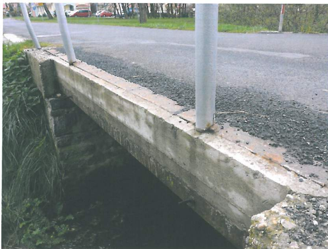
Fot. 18. Belka gzymsowa od strony dolnej wody. Widoczne mocowanie balustrady do istniejących stalowych elementów belki gzymsowej.
