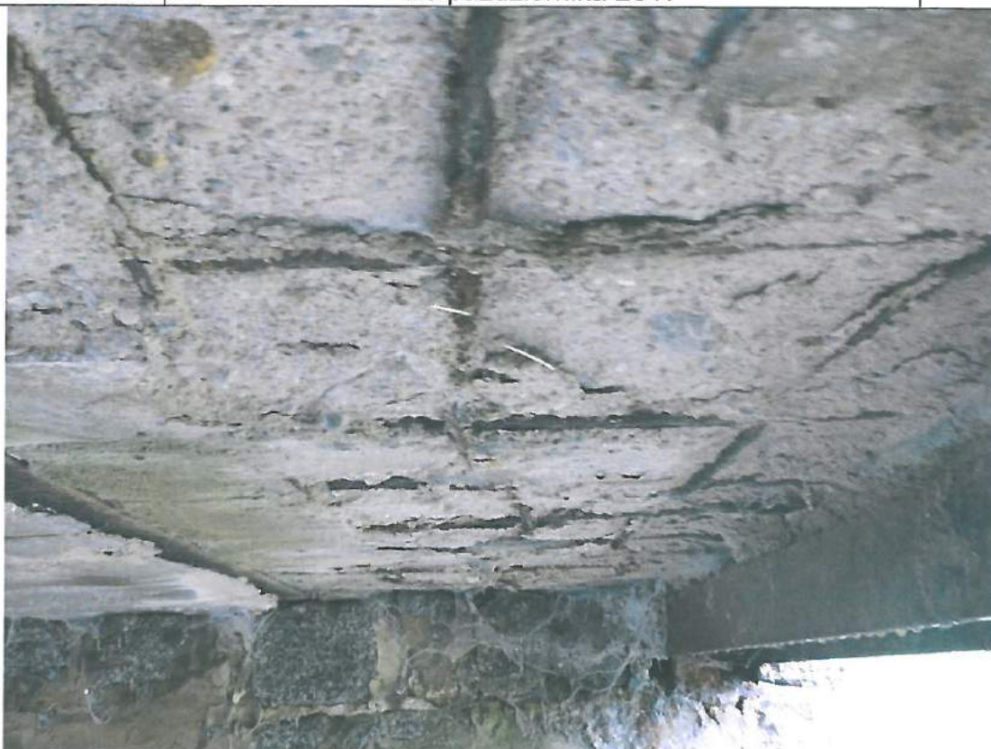
Fot. 9. Widoczny spód konstrukcji w rejonie belki gzymsowej, korozja odspojenia i ubytki betonu, zaawansowana korozja zbrojenia.
