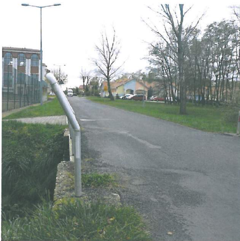
Fot. 19. Balustrada stalowa na obiekcie nie stanowi normatywnego zabezpieczenia przed wypadnięciem pojazdów poza obiekt brak wydzielonego ciągu pieszego na obiekcie w pobliżu szkoły.
