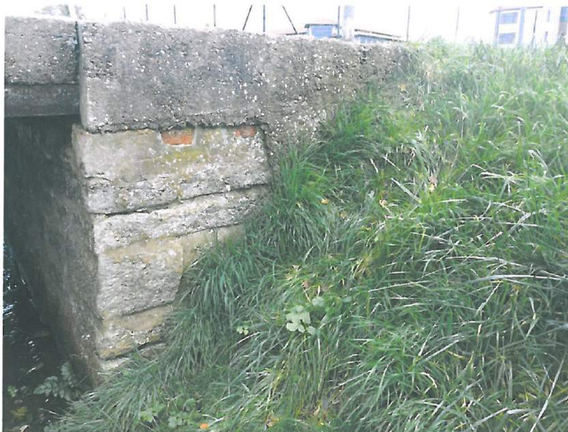
Fot. 14. Skrzydło prawobrzeżne od strony dolnej wody, korozja betonu elementu.
