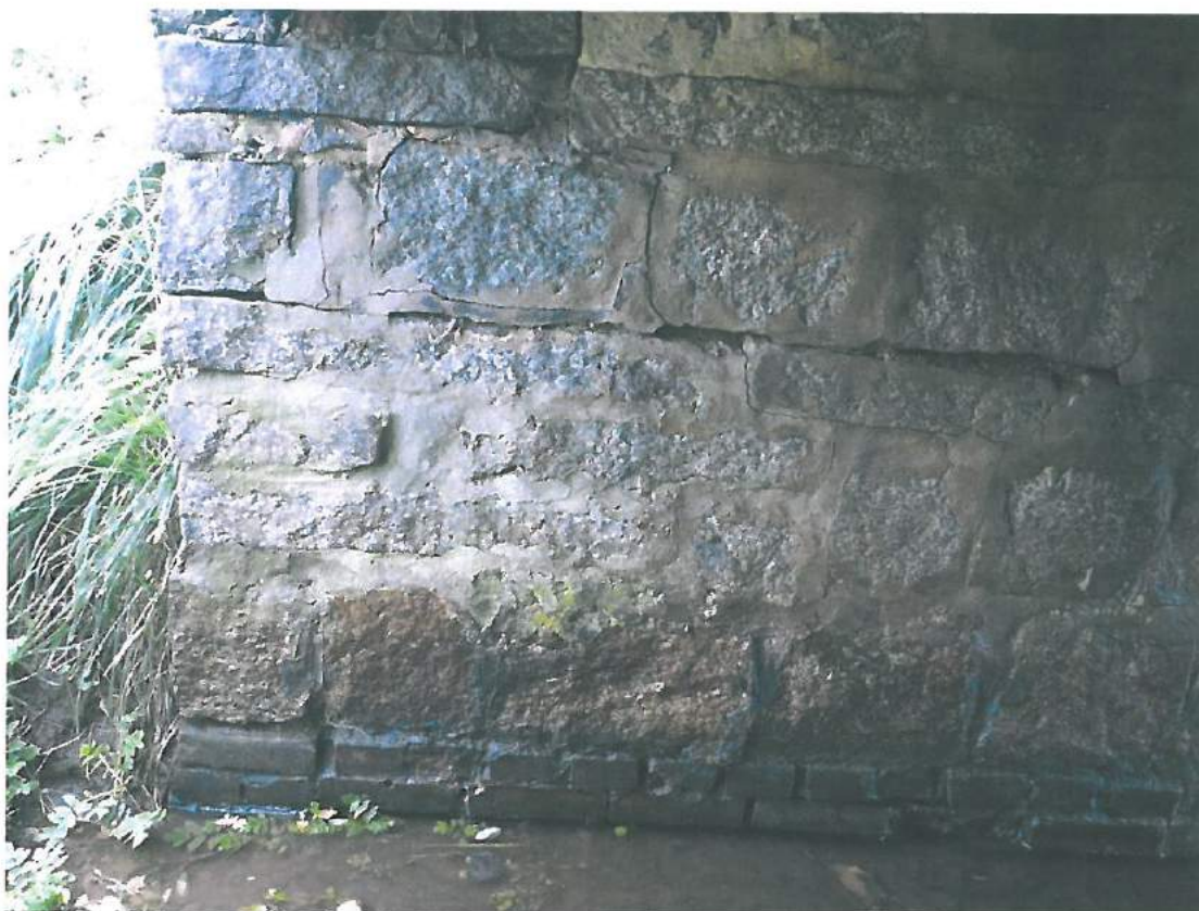
Fot. 12. Przyczółek prawobrzeżny od strony dolnej wody widoczne ubytki i rozluźnienie spoin, zacieki, w dolnej części ceglana część korpusu.
