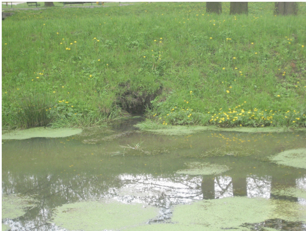
Fot. 4. Uszkodzona skarpa zbiornika
