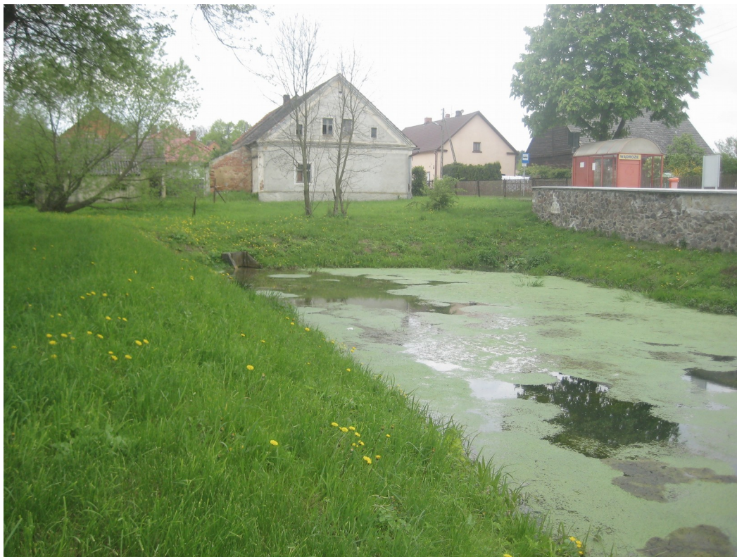
Fot. 3. Uszkodzona skarpa zbiornika
