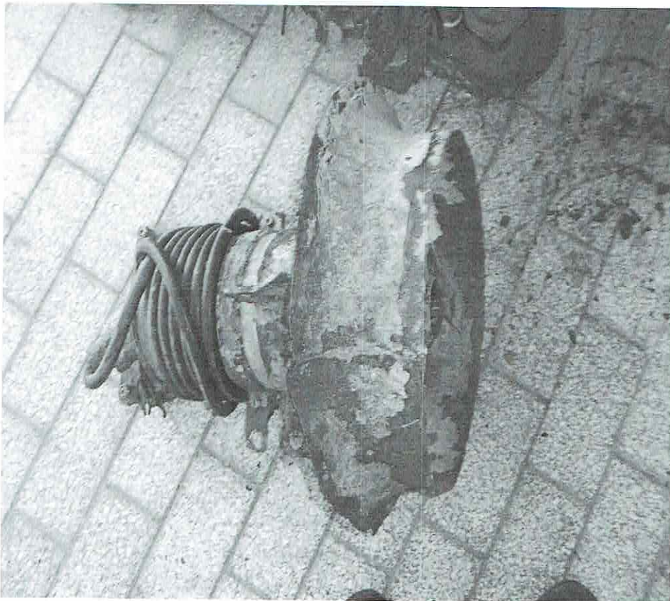
Mieszadła Hydromix szt.2 Uszkodzone
