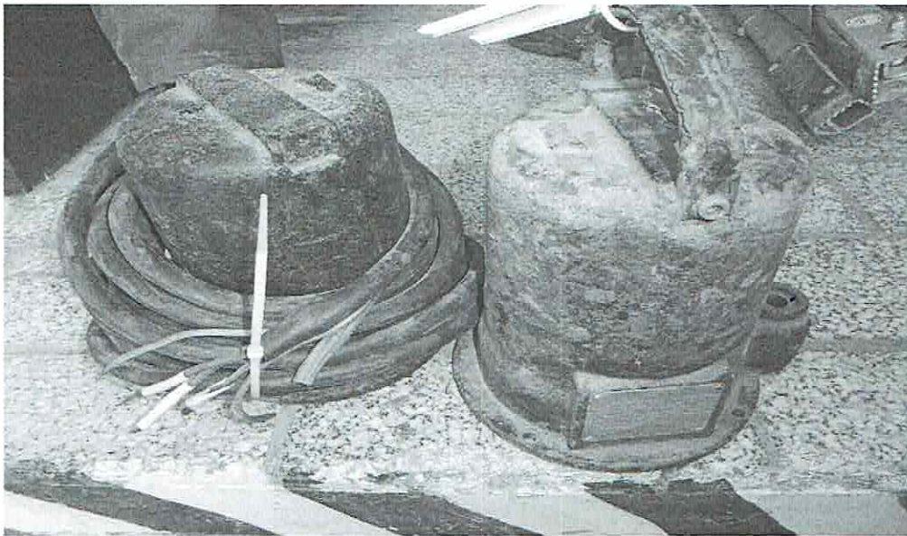
Pompy GRP 15 Uszkodzone 2 szt.
